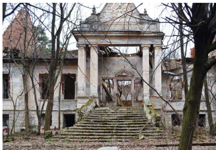
Cenná architektonická pamiatka, kaštieľ v Skároši, je v dezolátnom stave.
