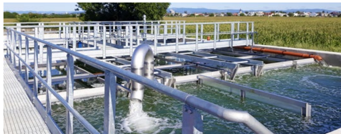
Technologická časť ČOV
